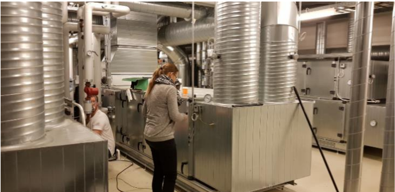
Kuva: Kuvattu käytännön mittauksia tehdessä energiatekniikan insinööriopiskelijoiden kanssa. Kuvassa on Karhulan uimahallin poistoilmakone, johon pilotoidaan lisälämmöntalteenotto lämpöpumpputekniikalla (TP3). Kuvaajana Xamk Tuija Korpela.
